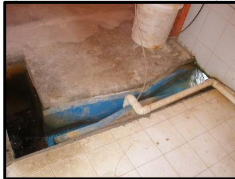
Fotografía 77 Canaleta Parshall. Adición de Coagulante.
