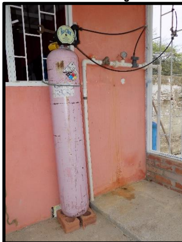
Fotografía 80 Cilindro de cloro gaseoso.
