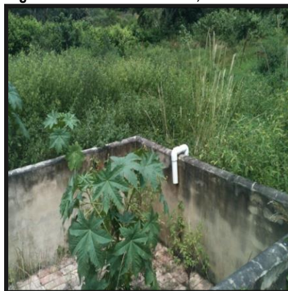
Fotografía 84 Sistema Aeróbico, PTAR Municipal.
