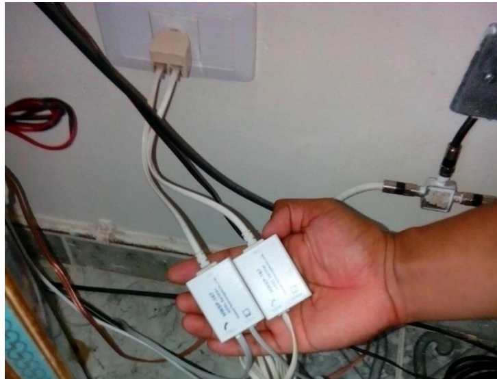
Figura 51. Derivación de red telefónica para el servidor. Fuente: Autores
