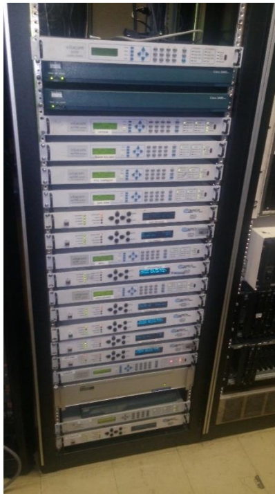
Figura 53. Equipos Instalados en Aerocivil Bogotá
