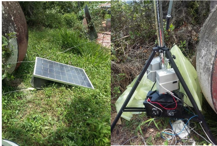
FIGURA 38 SISTEMA FOTOVOLTAICO INSTALADO EN SAN JOSÉ
