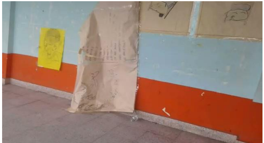
Figura 8. Contaminación visual en las paredes de los pasillos
