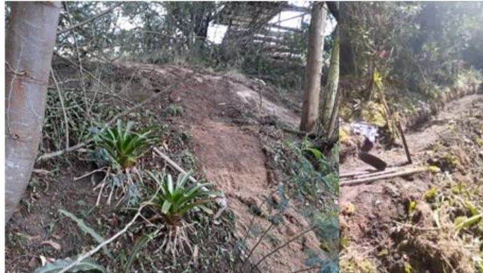
Figura 3: Escaleras de acceso al apiario. adecuación del terreno para instalación de trasiegos.
