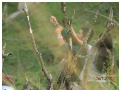
Ilustración 79 Amarrando el cable a una vara que también sostiene el cable eléctrico.
