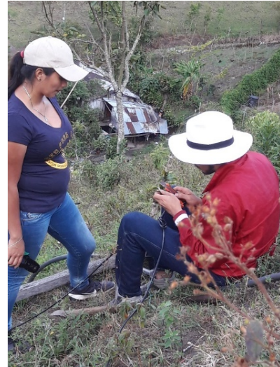
Ilustración 50 Empalme del tendido eléctrico.
