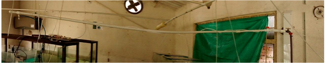
Figura 19 Conducto de agua tanque de reserva –acuario
