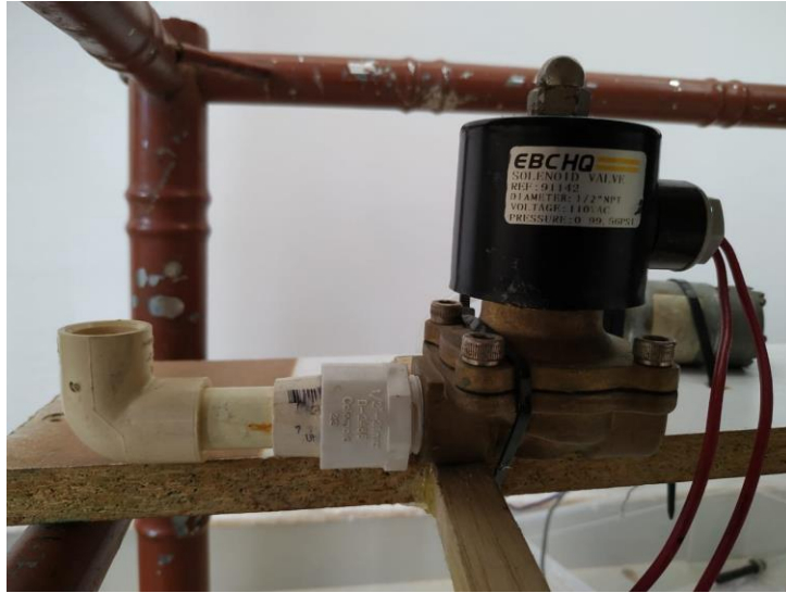
Figura 72. Válvula implementada en el sistema
