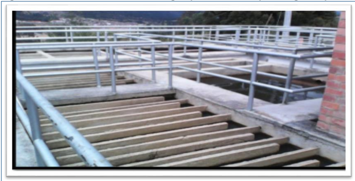
Figura 10. Planta de tratamiento de agua potable municipio Lenguaque
