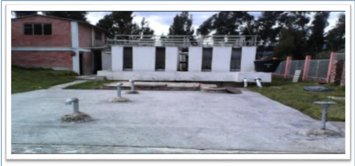
Figura 9. Planta de tratamiento de agua potable municipio de Lenguaque
