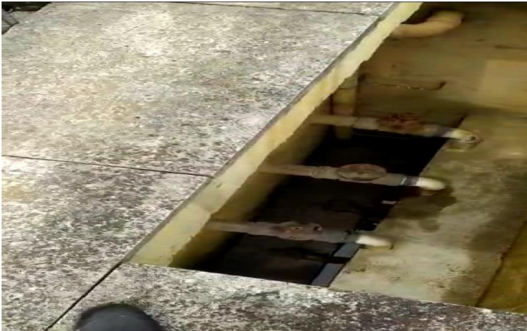
Ilustración 8: Retro lavado por Filtros.
