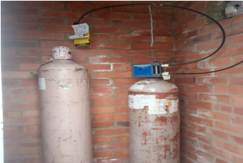
Ilustración 11: Tanques de cloración.
