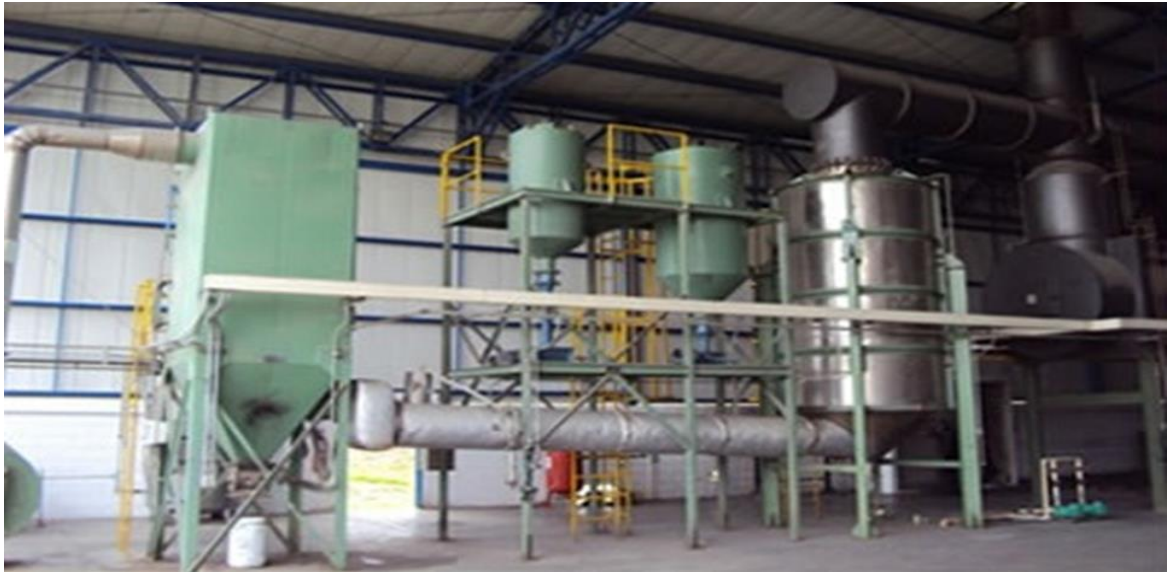
Figura 10. Horno incinerador de residuos especiales y peligrosos
