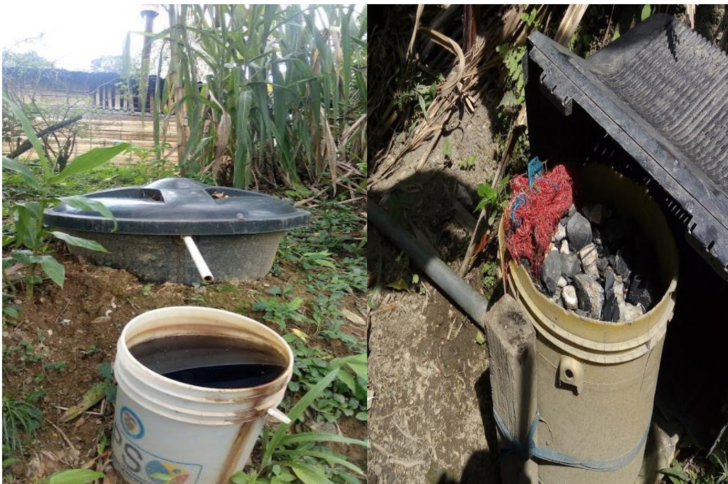
Figura 11-21 Trampas de grasas instaladas en las fincas de Vista hermosa y El Paraíso.
