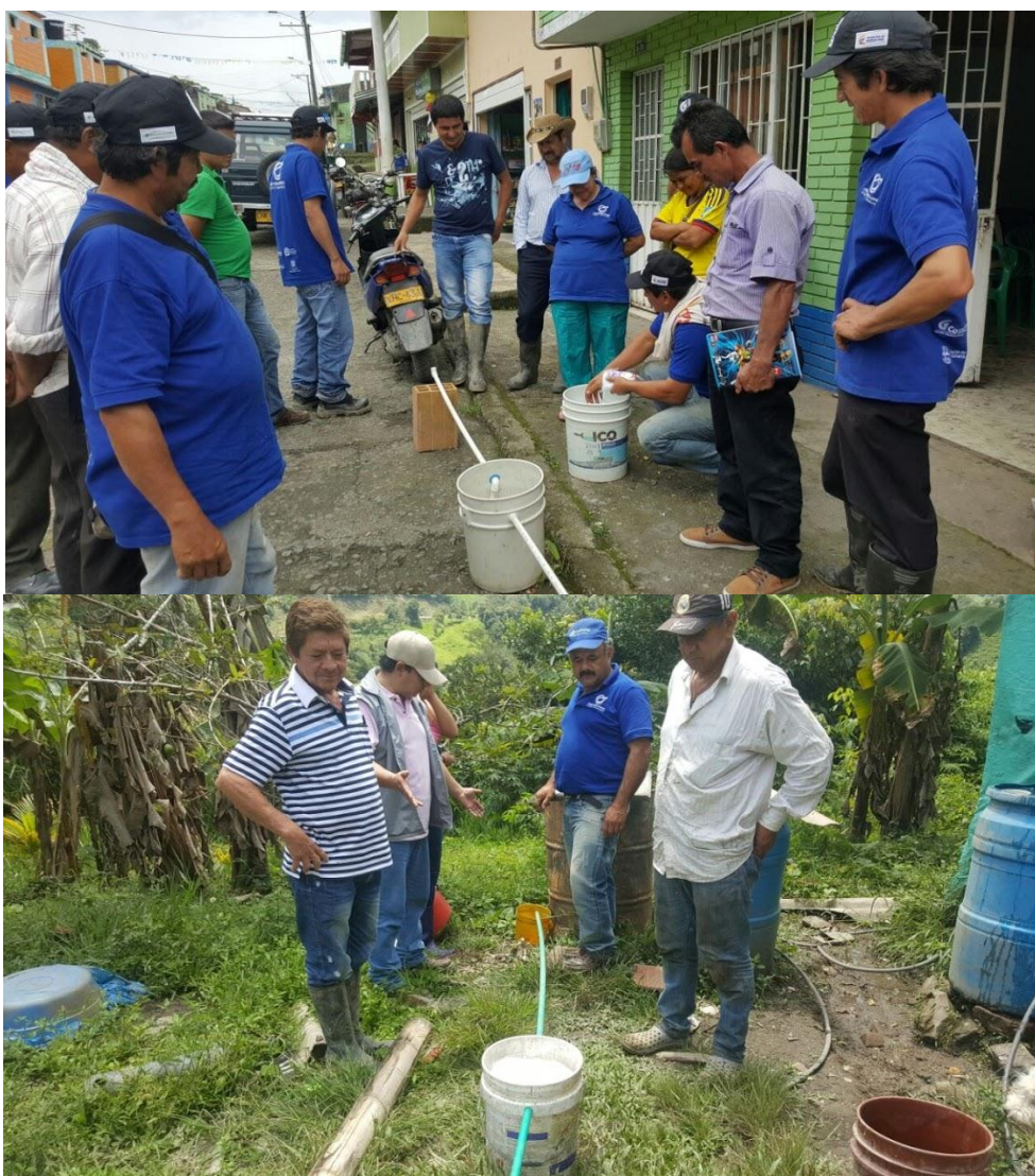
Figura 12-7 Elaboración de trampas de grasas por parte de agricultores socios del proyecto CTA2 Caña panelera en los municipios de La Peña y Topaipí.
