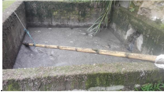
Figura 33 Tanque destapado generados de olores, además posee fugas que vierten a potrero aledaño.
