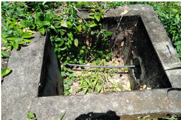
Ilustración 6. Canal de agua captada Autor: Fuente propia
