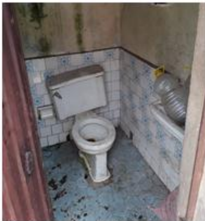
Baño para los trabajadores
