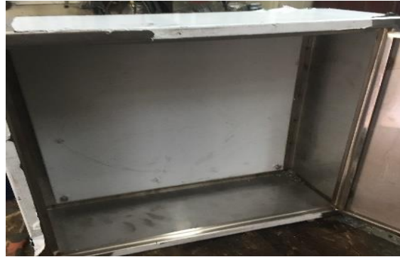
Baúl de tablero eléctrica [Figura 30]
