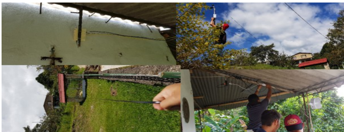
Figura N° 13: Instalación Nodo comunidad familia Padilla (Autor).
