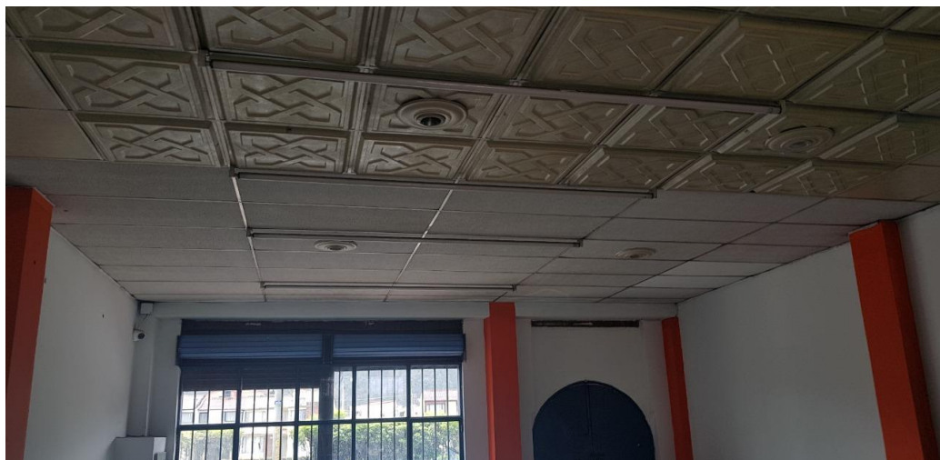
Ilustración 10. Iluminación artificial actual.
