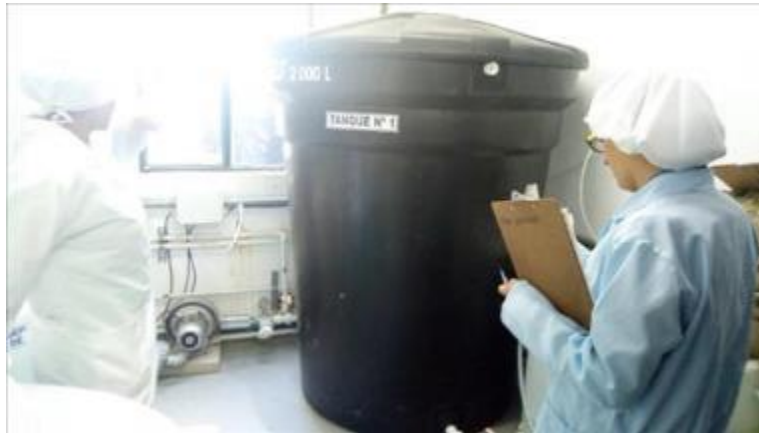
Figura 32. PTAR Empresa No. 1. Fuente: elaboración propia.
