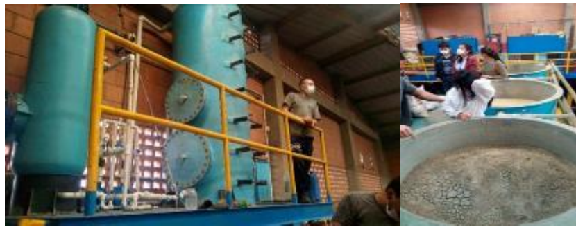
Figura 34. Vista PTAR Empresa No. 2. Fuente: elaboración propia.
