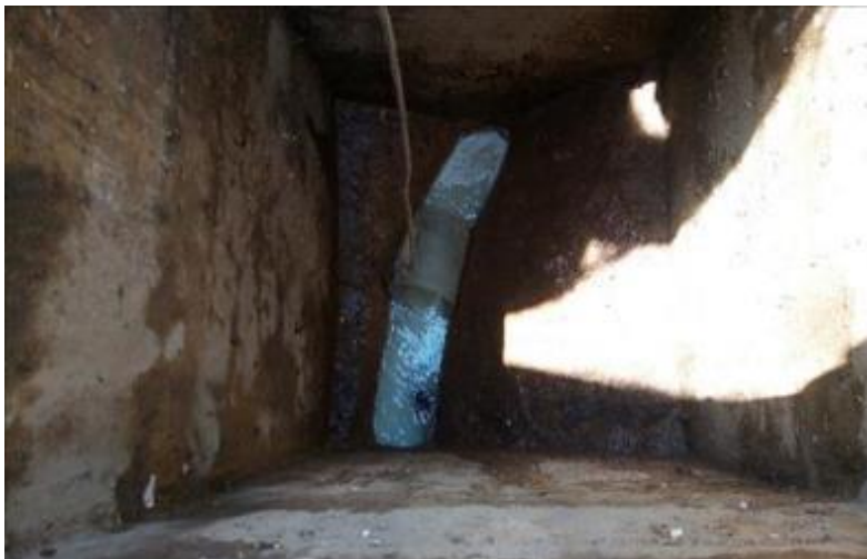
Figura 41. Muestreo Puntual Caja de inspección Externa, empresa No. 4. Fuente: elaboración propia.
