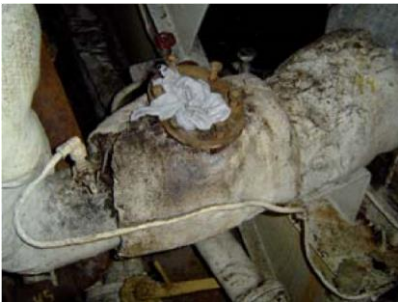
Figura A1.29 Detalle de calorifugado (textiles)
