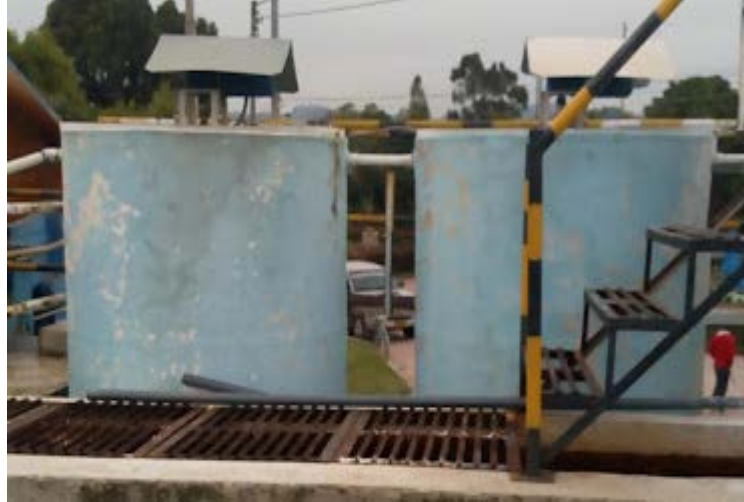
Figura 4. Tanques dosificadores de cal de la E.A.F. S.A.S. E.S.P
