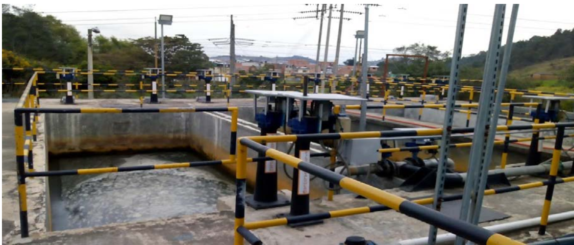
Figura 9. Filtros de la planta de la E.A.F. S.A.S. E.S.P.
