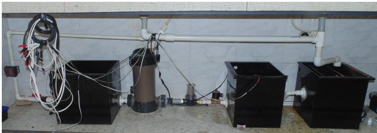
Figura 6 Prototipo modificado e instalado
