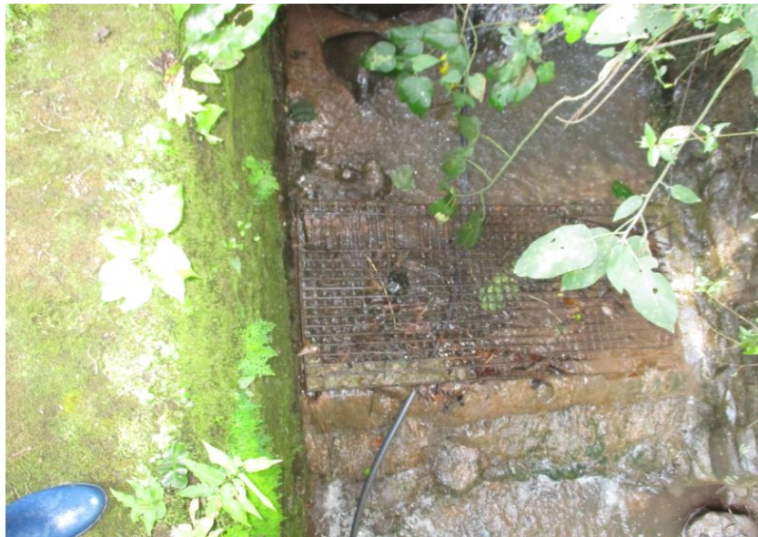
Fig. 3 Rejilla y punto de captación de agua para la bocatoma y previo sistema de distribución a los usuarios
