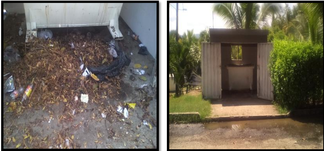
Figura 10 condiciones de almacenamiento UTAI Sede Social
