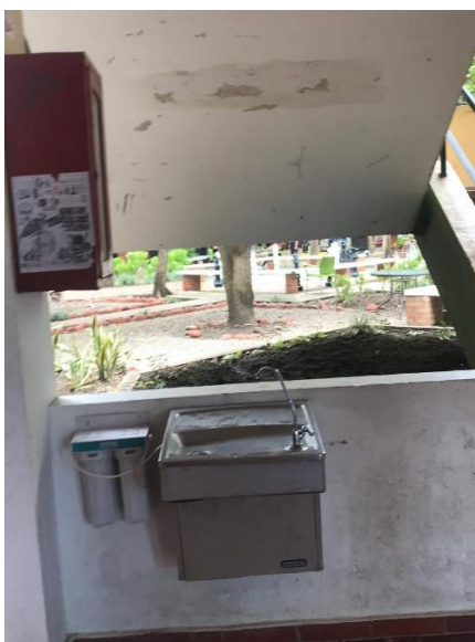
Fuente: propia Ilustración 21: Dispensador escaleras 1 piso
