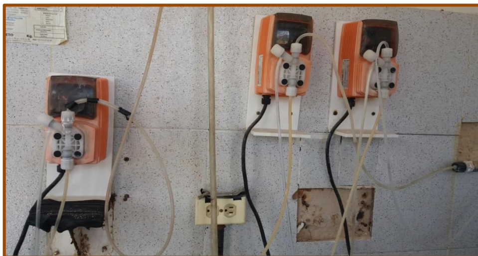
Imagen 6. Bombas dosificadoras. Fuente: Autor (Septiembre, 2016)
