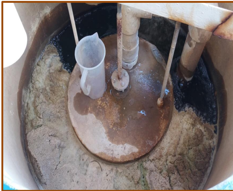
Imagen 7. Floculador. Fuente: Autor (Septiembre, 2016)
