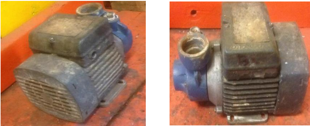
Fig. 21. Bombas de alimentación estado actual 2019, Fuente Propia
