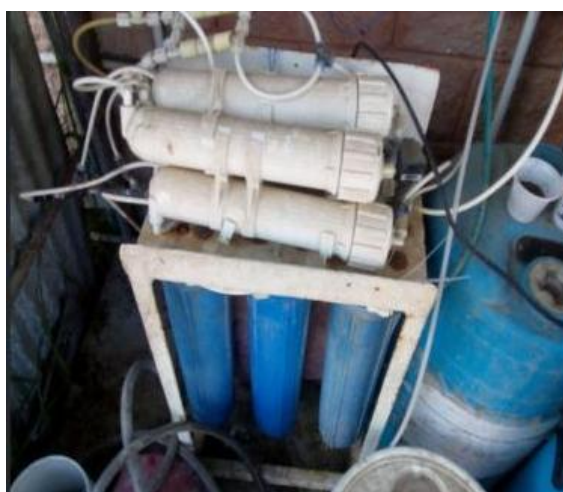
Fig. 20. Osmosis Inversa estado actual 2019, Fuente Propia
