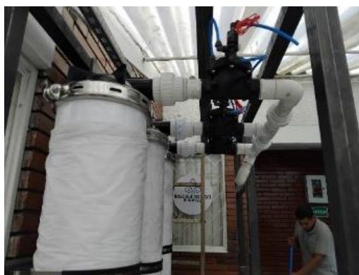
Figura 5. Instalación de un sistema dentro de la empresa.
