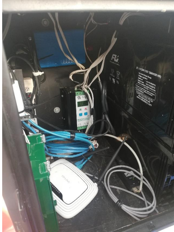
Figura 28. Etapa de adquisición de datos instalada en la caja de conexiones.
