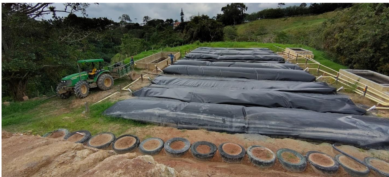
Ilustración 2 Biodigestores Granja Buena Vista (fuente de biol del estudio)
