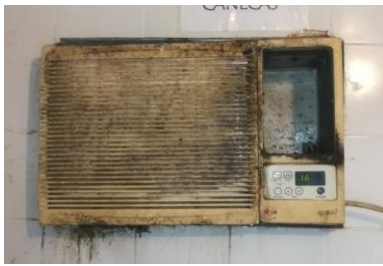
Imagen 8. Aire Acondicionado Obsoleto
