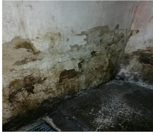
figura 7 Presencia de grietas y porosidad en las paredes
