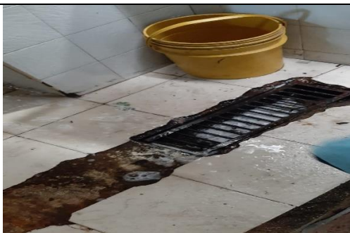
figura 10 Se evidencia drenajes deficientes y sin tapas
