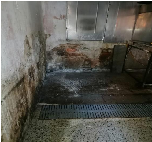
figura 8 Presencia de humedad en las paredes
