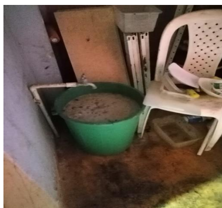
figura 5 Agua estancada en canecas cerca a otros muebles que se encontraban amontonados en el lugar.
