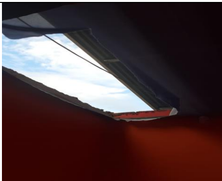
figura 14 Se evidencia hueco en el techo lo que puede ser causante de entrada de posibles plagas.
