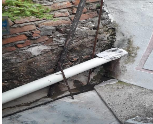
figura 17 Se evidencia infiltraciones por una de las tuberías del establecimiento
