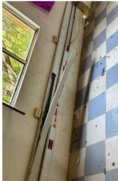
Imagen 32. Exposición del cableado eléctrico
