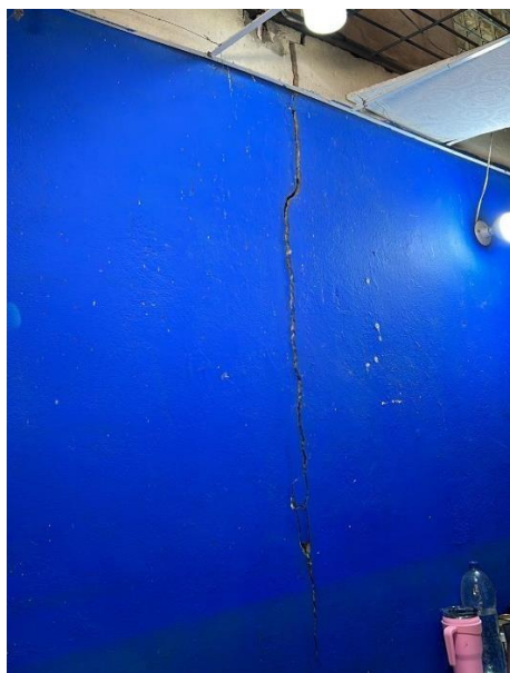
Imagen 10. Posible colapso estructural
