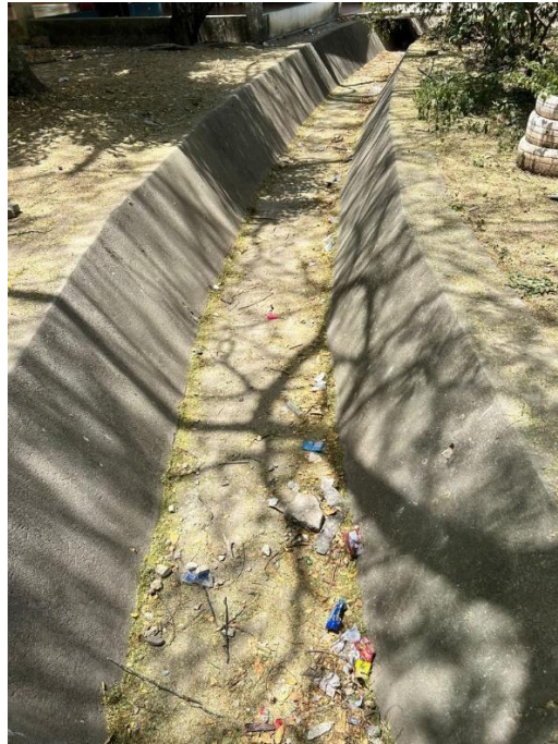
Imagen 20. Inundación por modificación de esorrentía
