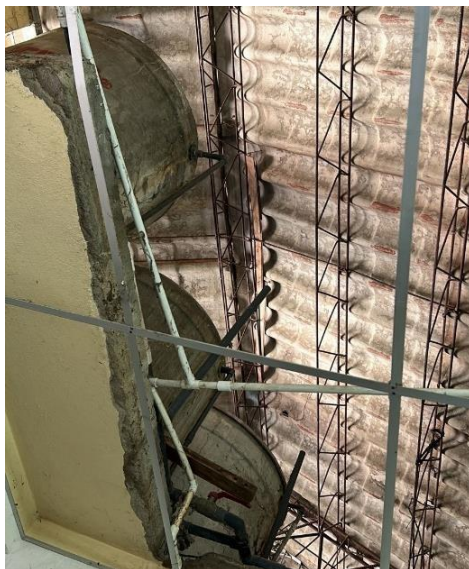
Imagen 9. Tanques de almacenamiento de agua en mal estado
