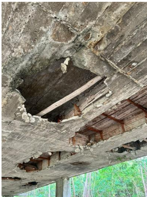
Imagen 14. Posible colapso estructural
