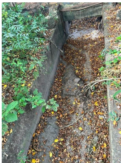
Imagen 12. Inundación del canal ubicado en la zona
