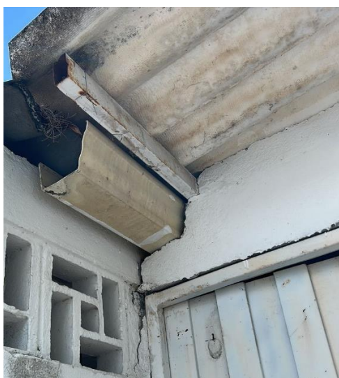
Imagen 6. Grietas en la infraestructura
