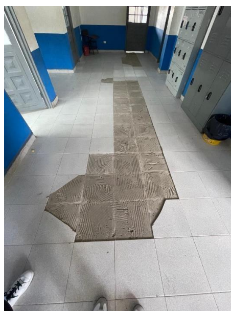
Imagen 2. Posible colapso estructural
