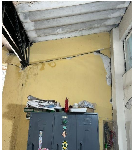
Imagen 18. Agrietamiento sala de profesores
