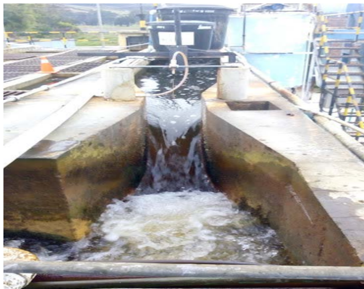
Figura 5. Canaleta Parshall implementada para la etapa de mezcla rápida
