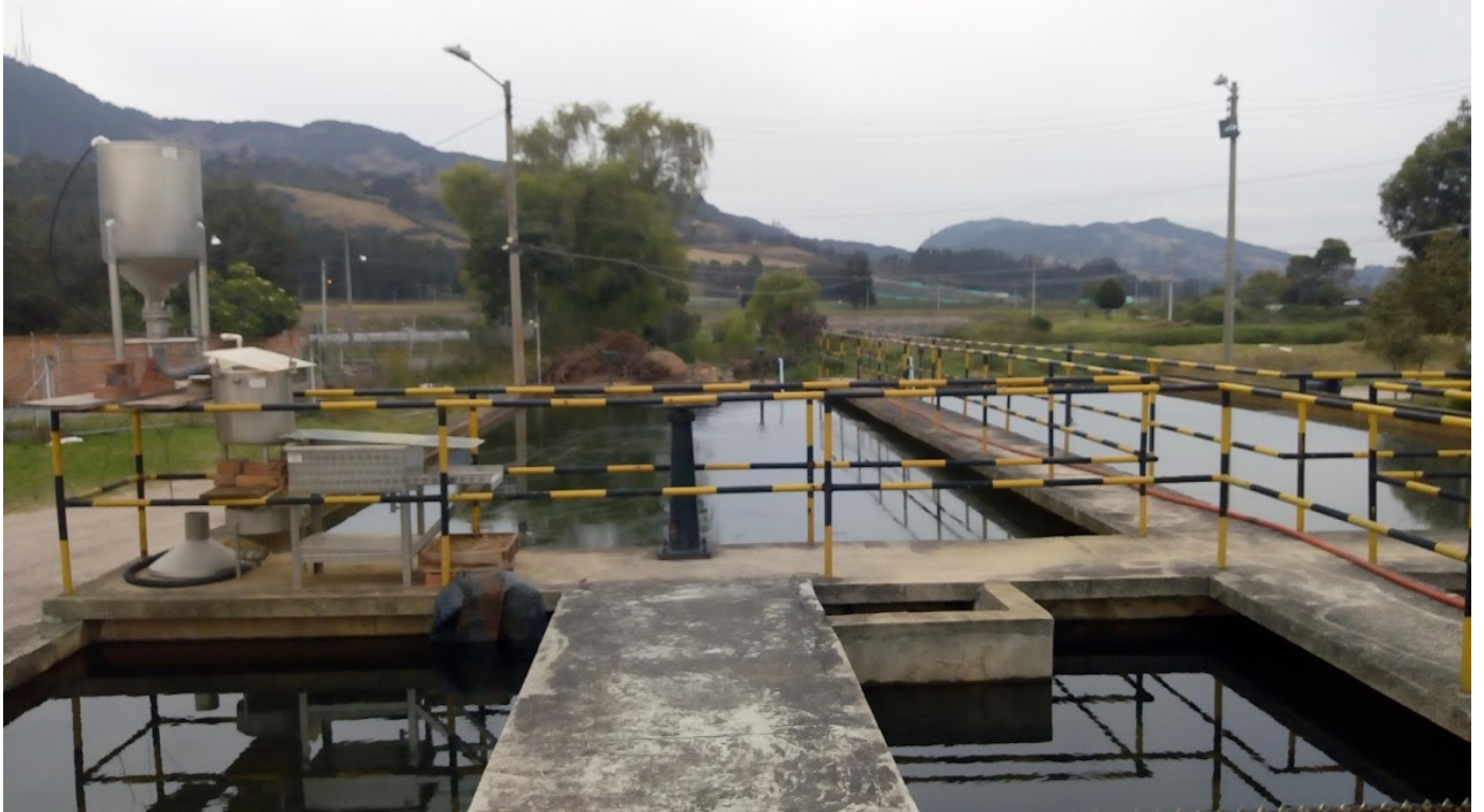
Figura 10. Sedimentador primario convencional de la PTAP de la E.A.F. S.A.S. E.S.P.
