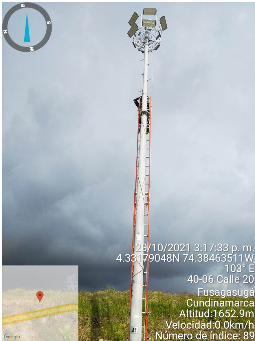
Figura 15: Instalación antena SkatePark Fusagasugá
