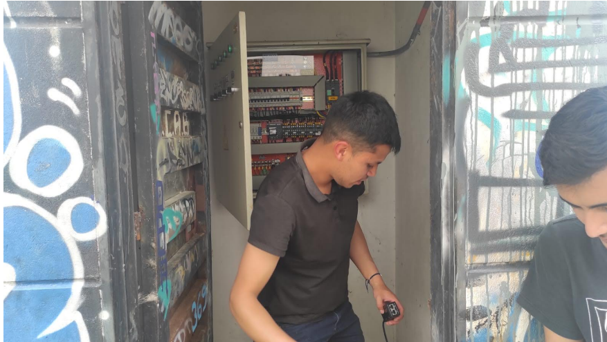
Figura 16: Tablero eléctrico Skate-Park y PoE Antena
