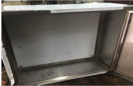
Baúl de tablero eléctrica [Figura 30]
