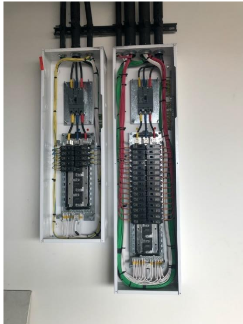
Figura 30. Peinado de cable en tableros
