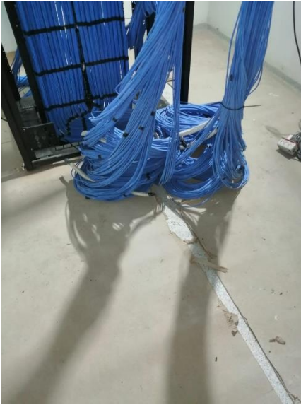
Figura 44. Llegada de cableado a los racks
