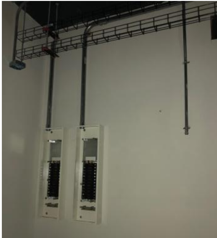
Figura 25. Infraestructura de tubería para llegadas de tableros
