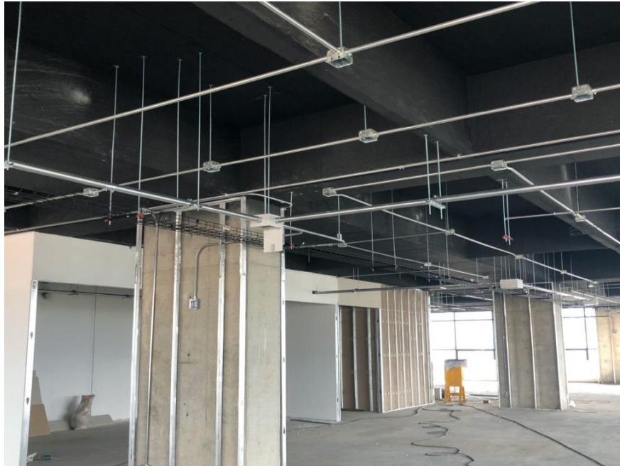
Figura 23. Infraestructura de tubería en zona de lockers
