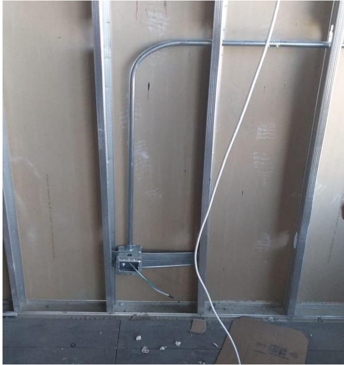
Figura 24. Infraestructura de tubería para tomas
