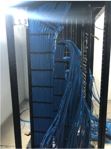
Figura 45. Peinado del cable en los racks
