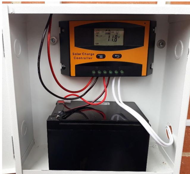
Figura 20 Caja de conexiones del regulador y la batería. Fuente: Propia
