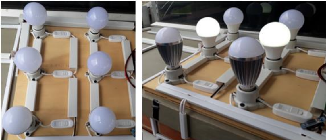
Figura 22 Implementación banco de cargas Fuente: propia
