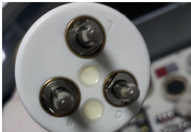
Ilustración 2, limpieza de cables de alta tensión en el generador a causa de arcos formados en el equipo.
