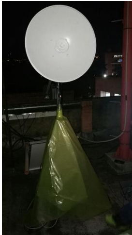
FIGURA 31 NODO INSTALADO EN EL BLOQUE F
