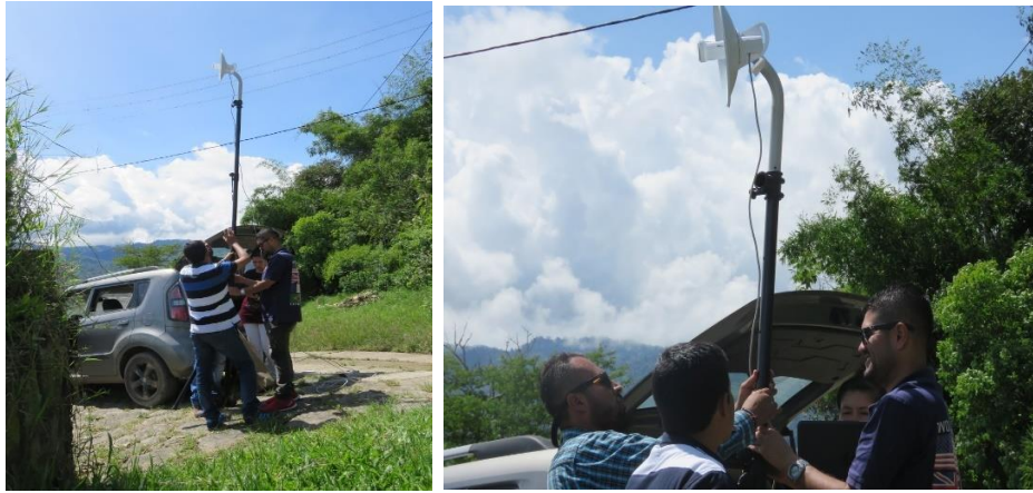
FIGURA 62 UBICACIÓN ANTENA POWERBEAM EN ZONA 4 VÍA SILVANIA
