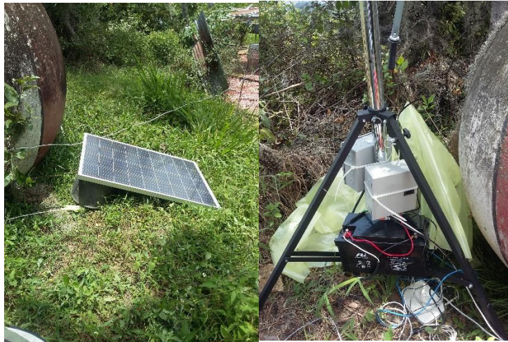
FIGURA 38 SISTEMA FOTOVOLTAICO INSTALADO EN SAN JOSÉ
