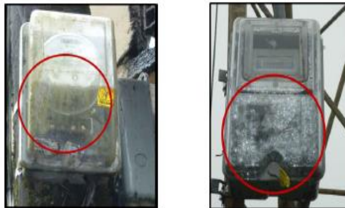
Figura 16. Medidores afectados herméticamente.
