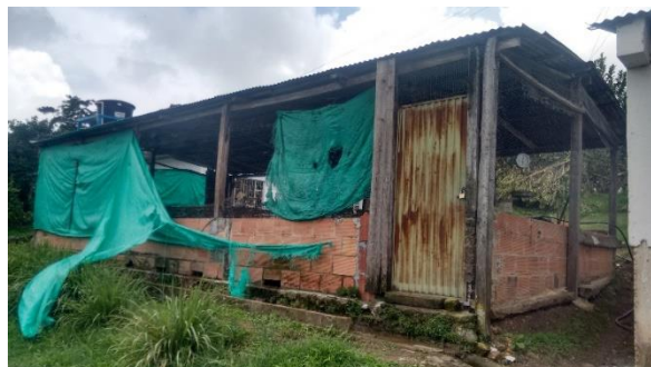
Figura 3. Cortinas en mal estado y carencia de pediluvios.
