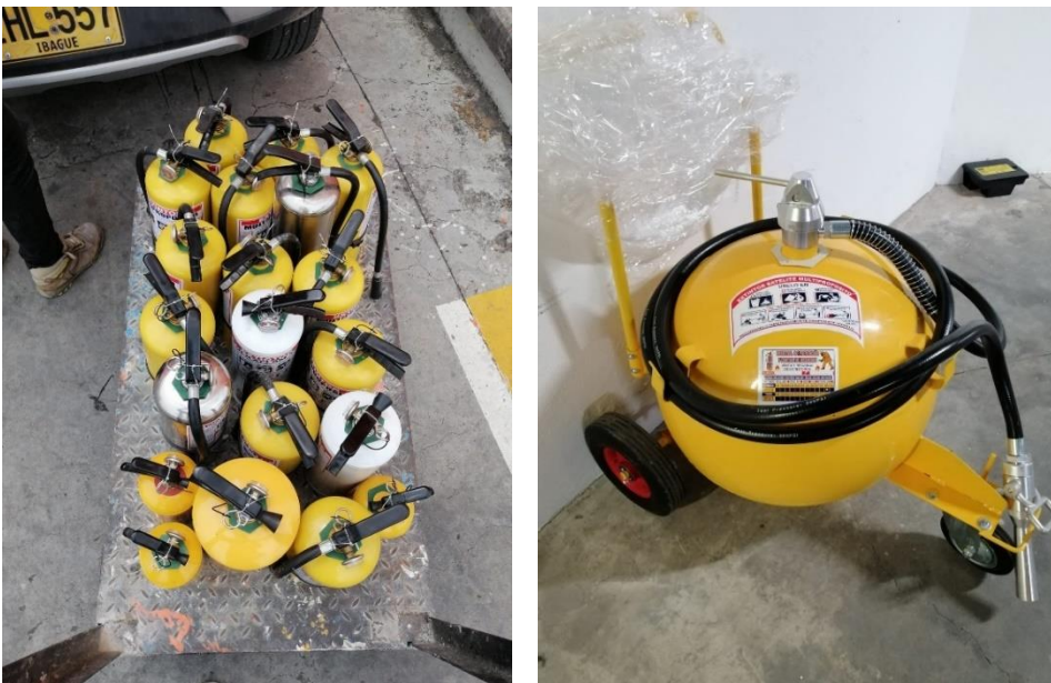
Ilustración 5. Verificación del estado de los extintores
