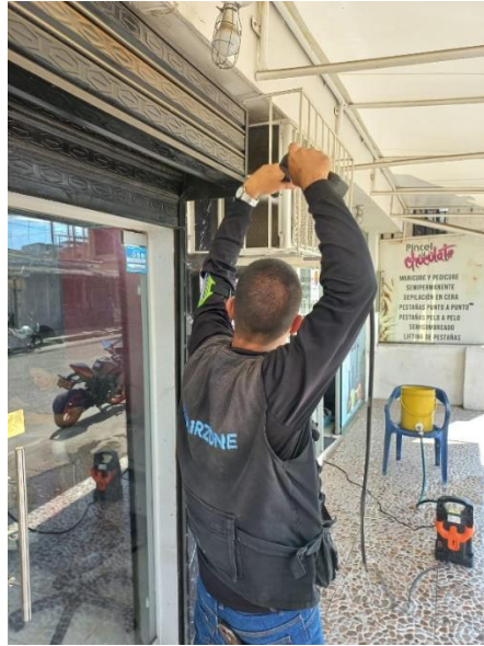
Ilustración 21 Lavado de la Condensadora
