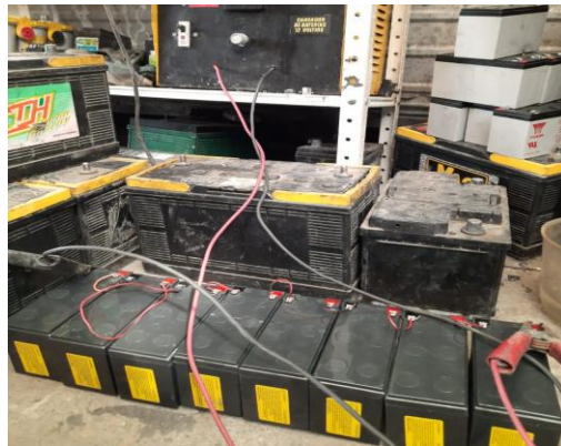
Figura 34. puesta a carga de las baterías
