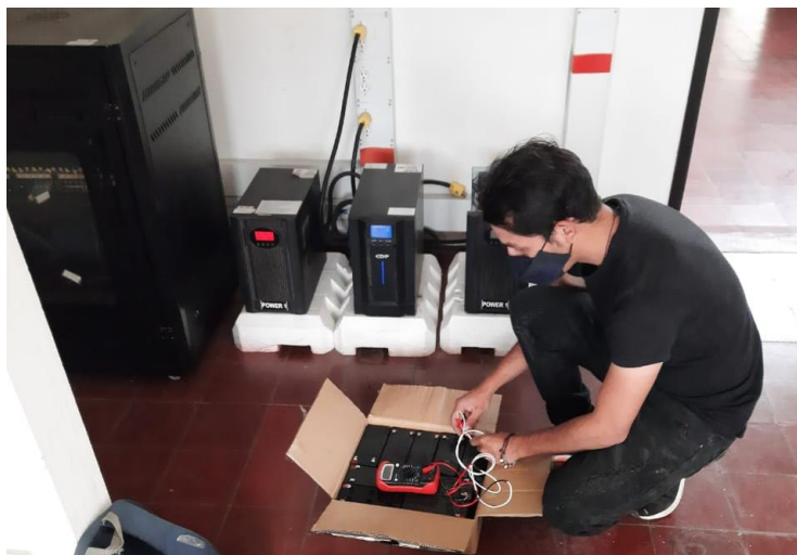
Figura 35 instalación de baterías en las UPS punto vive digital TAV
