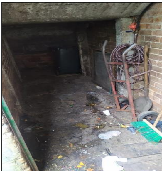
Figura 23: Cuarto de almacenamiento.
