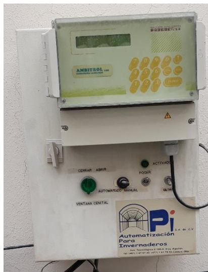
Figura. 4.4 Antiguo tablero de control.
