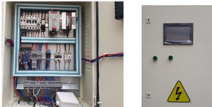
Figura. 6.3 Tablero de control.
