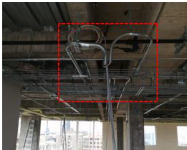
Figura 6. Infraestructura de bajantes derivadas de bandeja de rejilla
