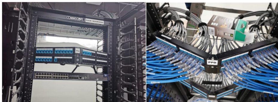
Figura 20. Marquillas de rack, panel de conexión, llegada de cableado de puntos de datos y cables de conexión.
