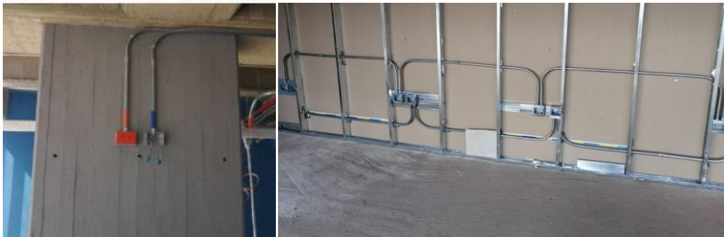
Figura 8. Infraestructura de puntos de datos para salas de juntas y puntos de TV en columnas de obra
