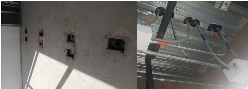
Figura 7. Infraestructura zonas de entrenamiento con módulos de conexión para mesas desde piso inferior
