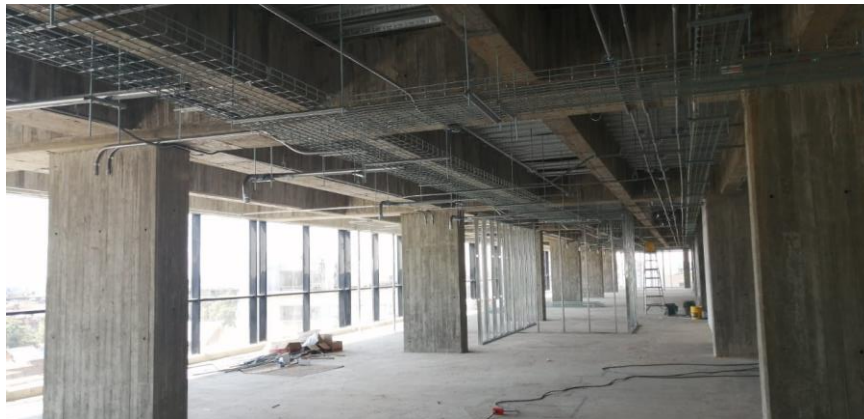
Figura 5. Infraestructura sistema cableado estructurado en áreas comunes con tubería EMT y bandeja de rejilla
