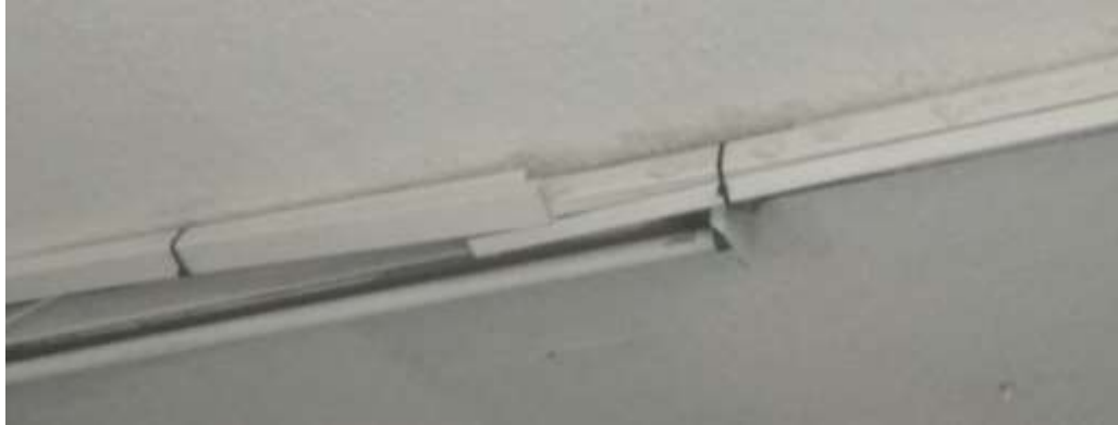
Figura 39 Canaleta en mal estado con cintillas negras..
