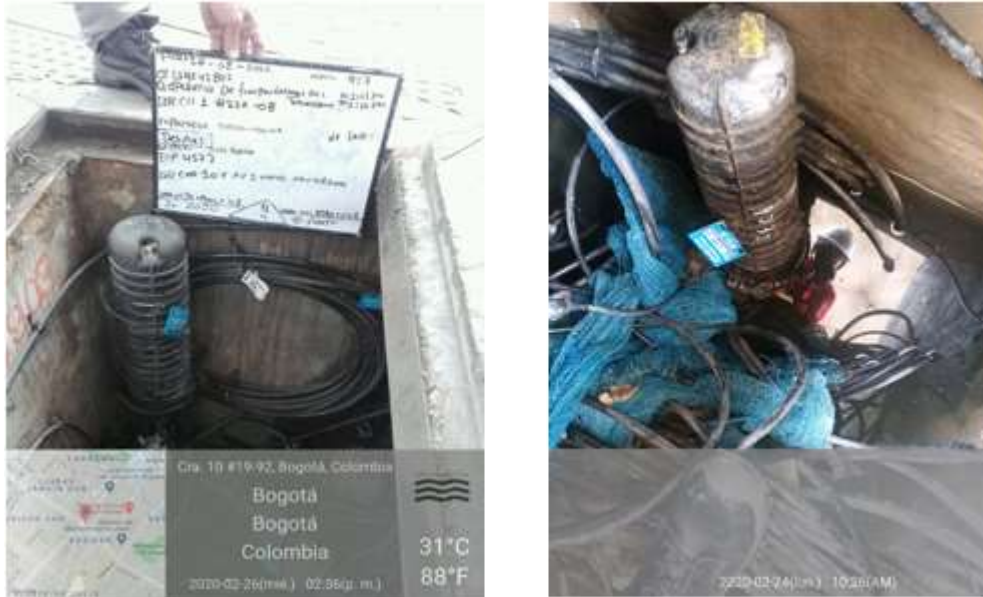
Figura 37 Adose de empalme canalizado.
