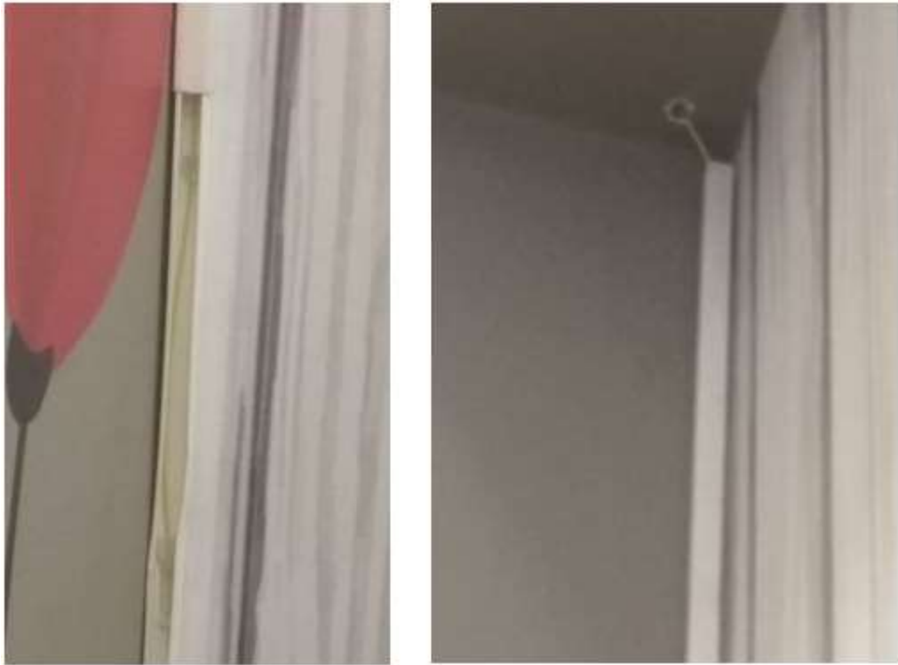
Figura 41 Canaleta en mal estado y falta de codo protector de fibra óptica.
