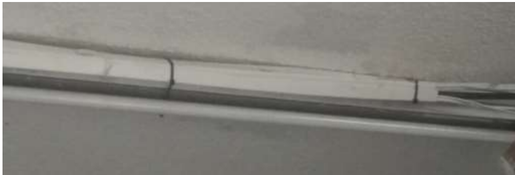
Figura 40 Canaleta en mal estado con cintillas negras.
