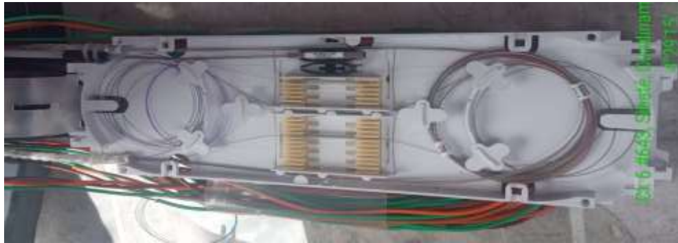
Figura 43 Splitter en bandeja de caja de empalme.
