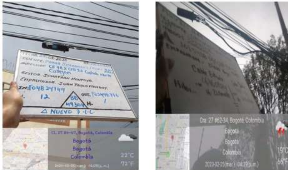
Figura 32 Adose de empalme aéreo.
